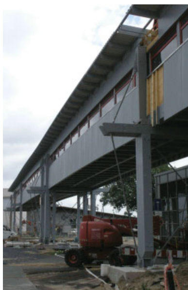
Bild 5. Fußgängerbrücke mit Hauptträgern aus BSH GL 32 h. Werden diese, wie im Bild, durch eine dauerhafte und hinterlüftete Verkleidung vor Witterung geschützt, gilt Nutzungsklasse 2; die Stützen sind allerdings in Nutzungsklasse 3 einzustufen
