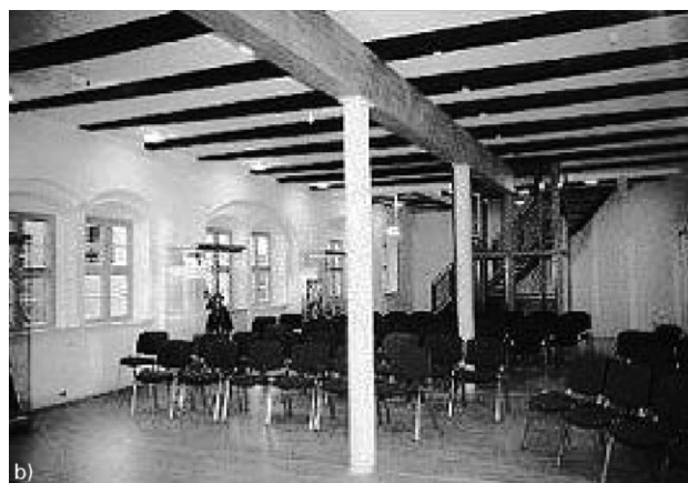
Bild 11. a) Verbundquerschnitt im Bereich der maximalen Balkendurchbiegung, Spannweite 4,5 bis 5,0 m b) Versammlungsraum im 1. OG nach der Fertigstellung
