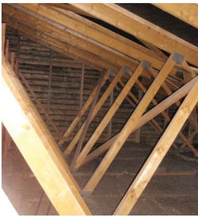
Bild 22. Fehlende Gurtungen beim Aussteifungsverband der Diagonalen; die Auskreuzung ist für einen Teil der Stäbe wirkungslos Fig. 22. Lacking trelliswork boom in bracing for diagonal members
