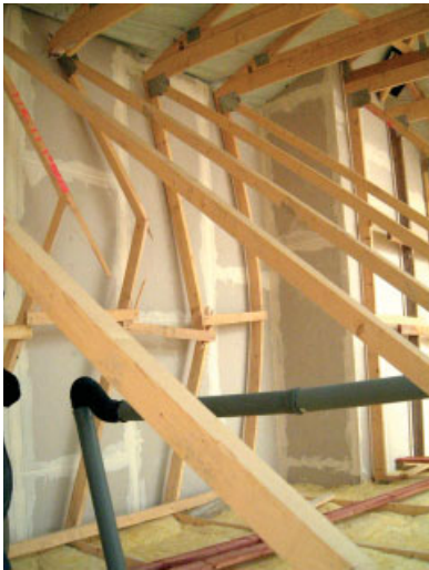
Bild 21. Teileinsturz eines Lebensmittelmarktes durch fehlende seitliche Knickaussteifung der Auflagerpfosten Fig. 21. Collapses of compression struts due to lacking bracing
