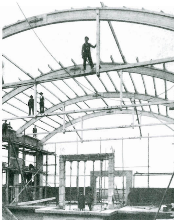
Bild 2.12: Beispiel Hetzerbauweise – ausgearbeitet von der Technischen Kommission des Bundes Deutscher Zimmermeister, Dreigelenkbogen mit Zugband, Ausführung: Zimmermeister Diehl, Groß-Gerau (aus [1.1])
