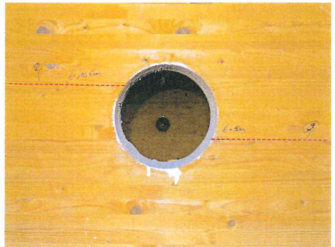
(3) Lastbedingte Risse in einem runden Durchbruch
